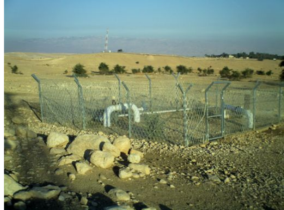
Système de pompage dans le désert de Neguev
